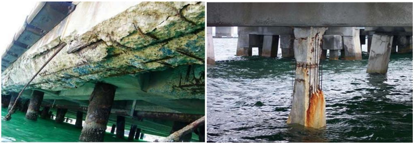
Hình 1.4 Sự phá hủy các công trình biển bê tông cốt thép.
